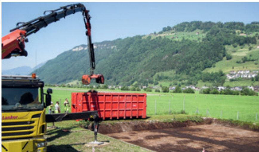
Erneuerung des Biofilters
