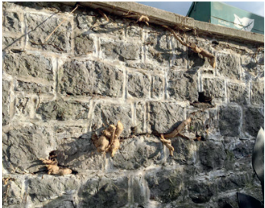
Mauerschäden durch Alterung, Witterungseinflüsse und Efeubewuchs
