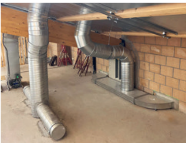
Zu- und Abluftkanäle
