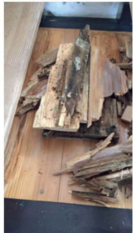
Verfaulte Unterkonstruktion Nothelferkapelle
