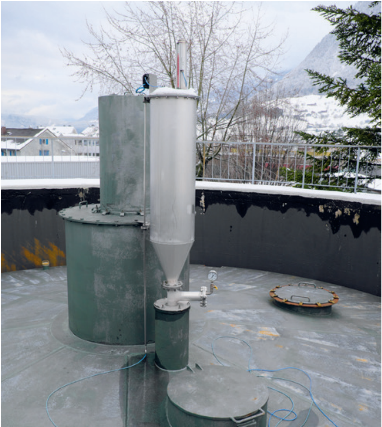
Faulturmabdeckung bei fast leerer Gasblase (hebt sich bis zu 3.5 m an)
