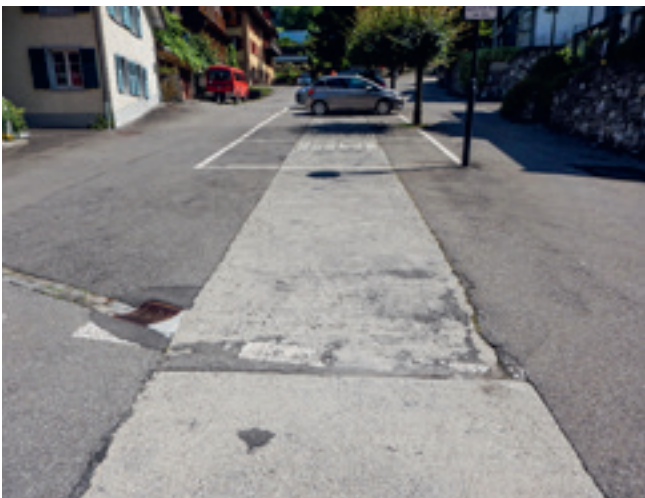
Alter Betondeckel Durchlass Dorfbach
