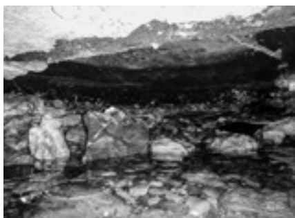
Ausspülung unter Betonplatte
