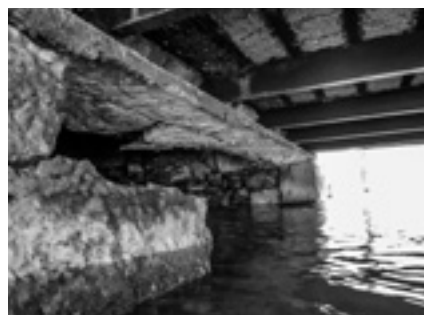
Eingebrochene Mauer an der Stirnseite der Mole
