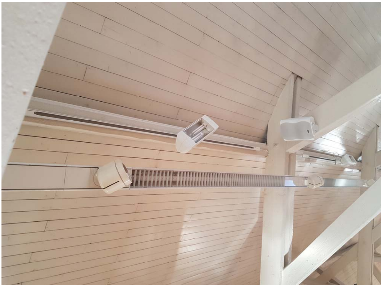
Beleuchtung und Beschallung
