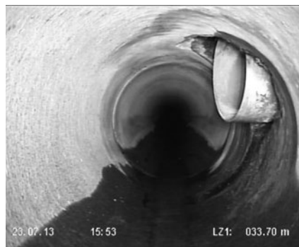
Nicht fachgerecht erstellter Blindanschluss → Hindernis
