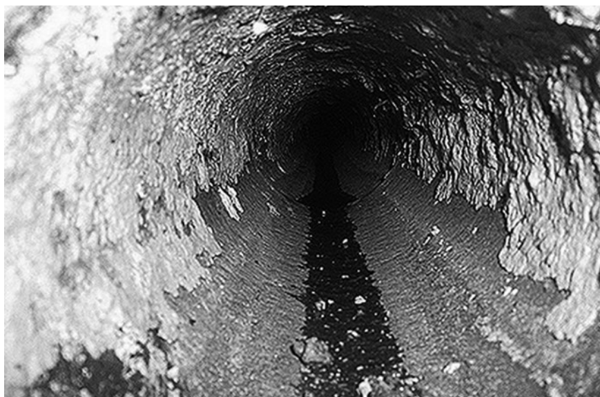
Rohr mit Ablagerungen
